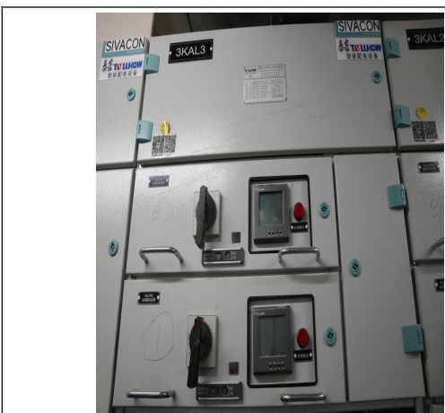
图 5 涉事配电柜（顶部）
