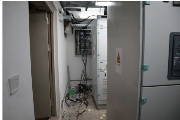
图 4 弱电电箱地面情况
