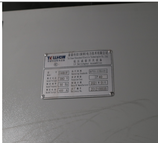
图 6 涉事配电柜铭牌
