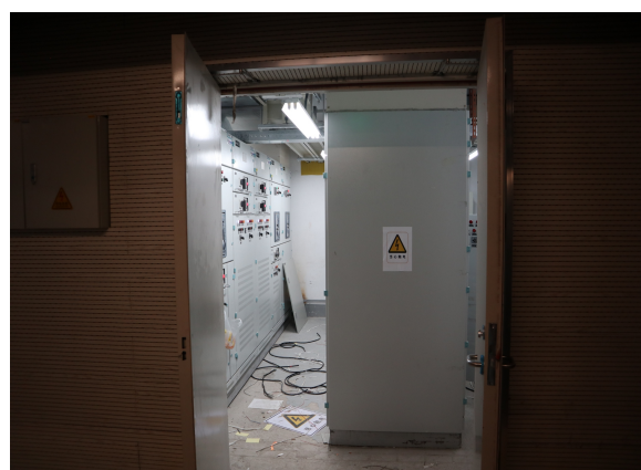
图 3 配电房进门处场景
