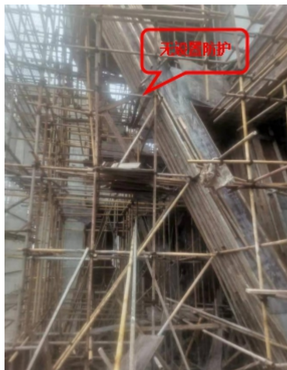
图 9 事故第一现场情况（即 2021 年 10 月 31 日现场实际情况）
