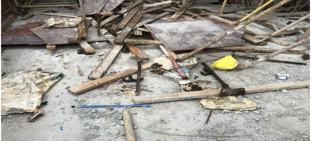
图 7 事故坠落现场
