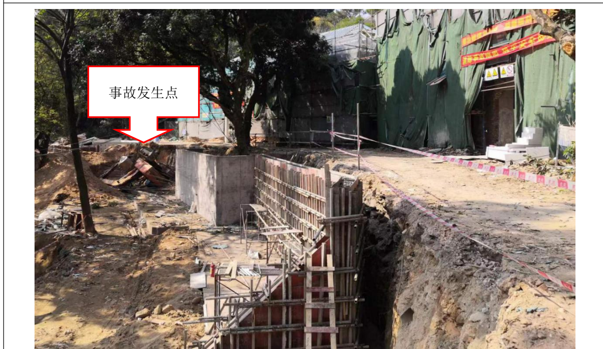
图 2 事故现场概况
