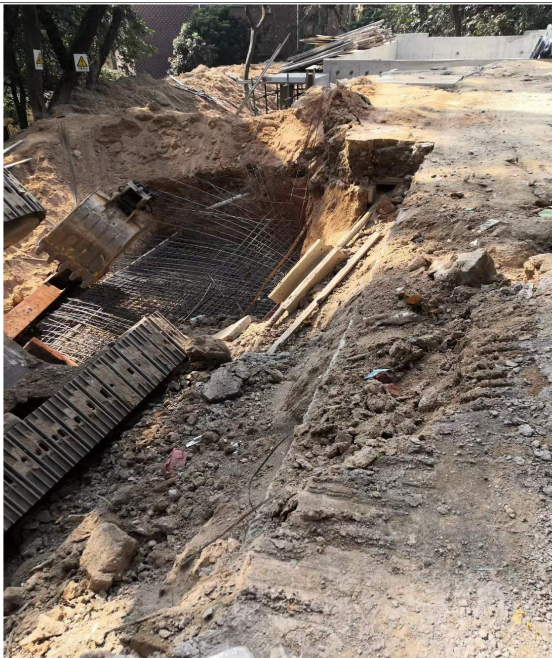
图 5 发生坍塌的外侧路面
