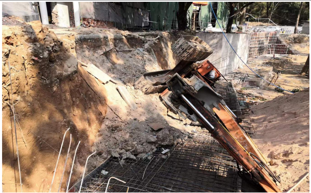
图 7 坍塌路段外侧边坡无支护措施
