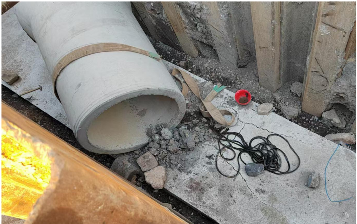
图 4 施工单位提供的现场照片（事发后拍摄）
