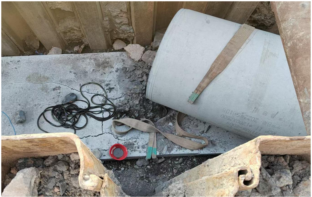
图 5 施工单位提供的现场照片（事发后拍摄）
