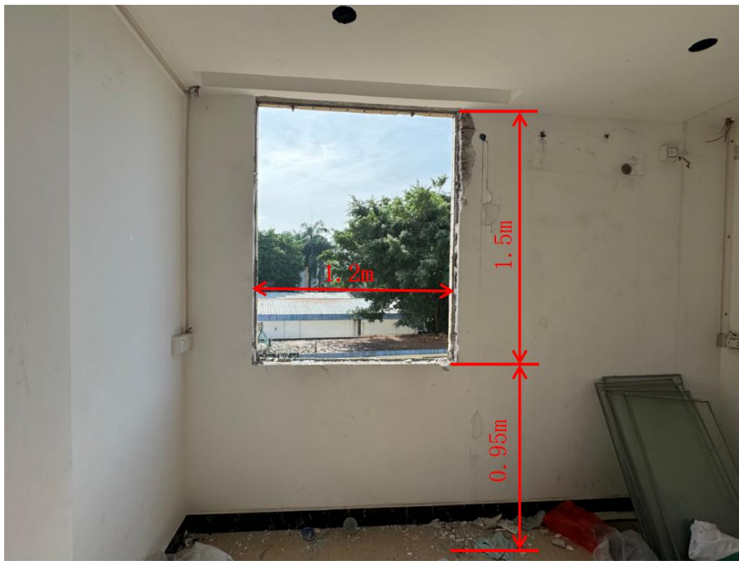
图 4 涉事窗户洞口室内概况
