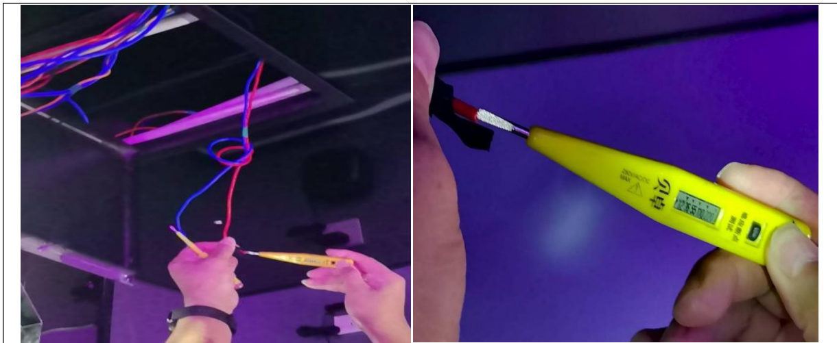
图 7 从主电线路引出电线组和电压测试情况
